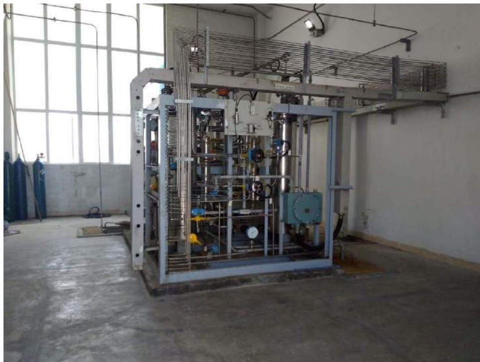
Tubing Size ¼ Setelah Terpasang Menggantikan Polyuretane Tube
