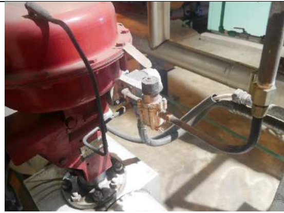
Tubing Copper yang sering Bocor pada Control Valve
