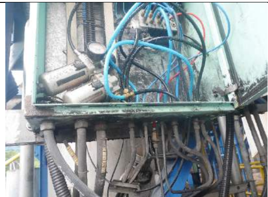
Tubing Plastic sering Lepas pada Control Panel
