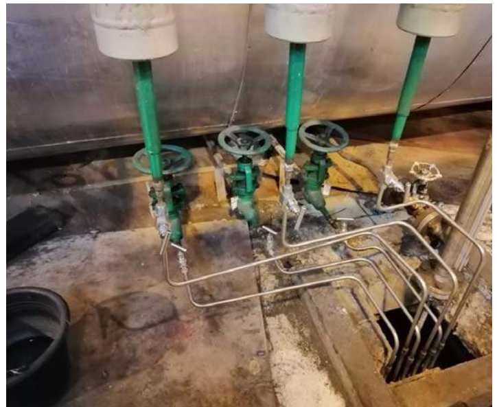
Tubing Terpasang Pada Tapping Point Steam Drum dengan adapter Welded
