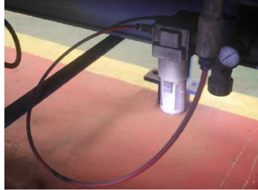
Tubing Plastic yang sering Bocor pada Control Actuator
