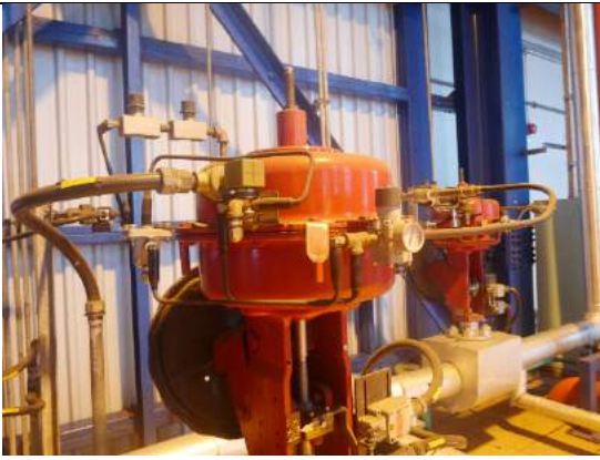
Tubing Copper yang sering Bocor pada Control Valve
